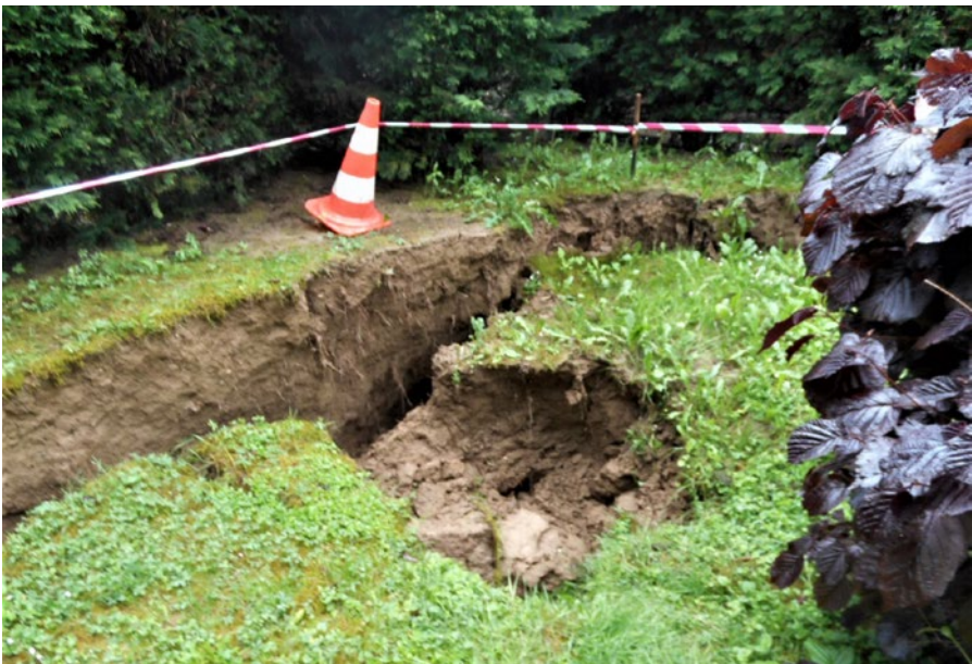
Affaissement à Boulot
